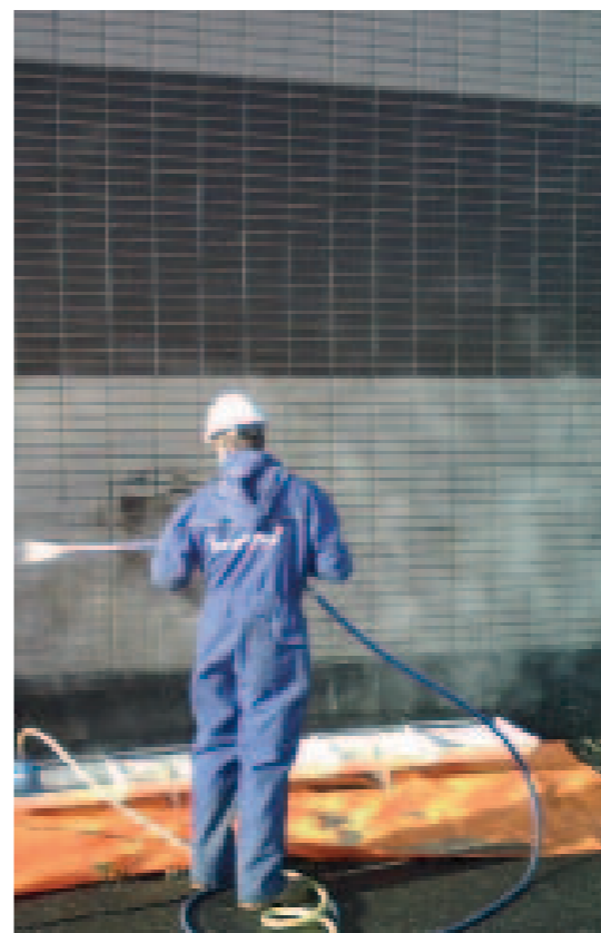
'Als er meerdere lagen graffiti over elkaar heen zijn gespoten dan is een chemisch middel eigenlijk wel noodzakelijk.'
